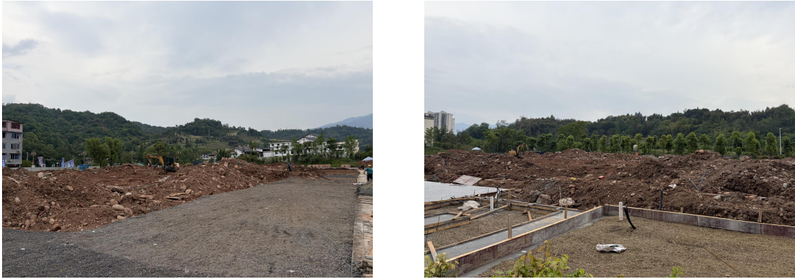
图 2.1-4 大面积裸露且无排水措施
